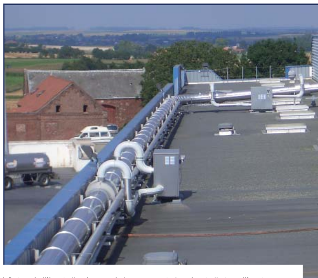
Vista dell'installazione del grosso tubo installato all'esterno
